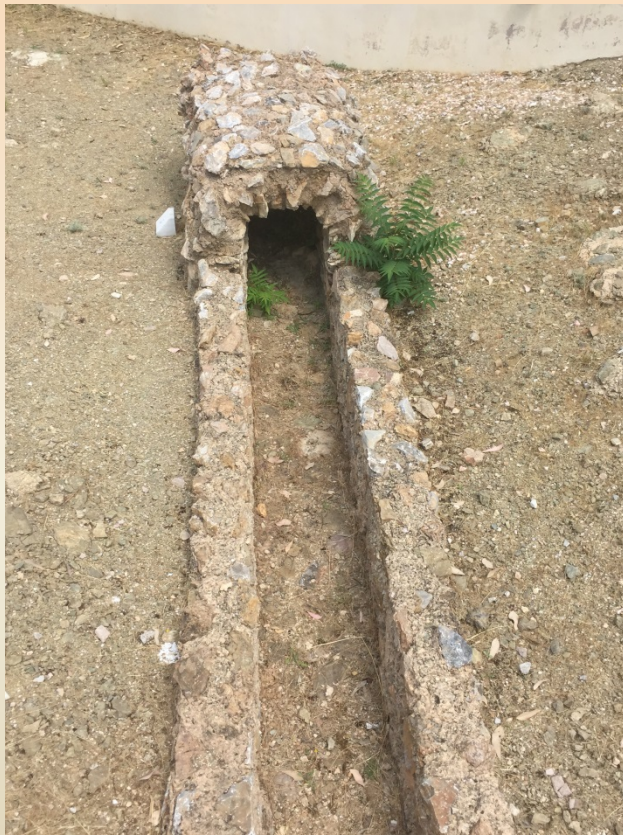
Τμήμα του αγωγού
