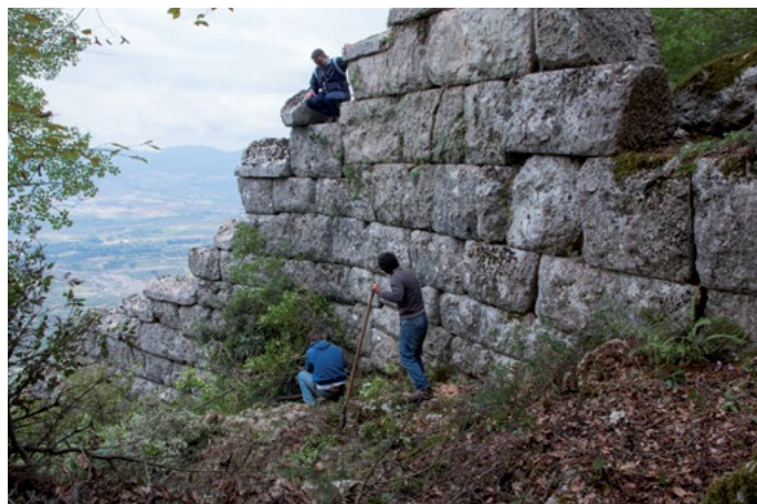
1 Tithorea, Reinigungsarbeiten an der Stadtmauer (2016) | Τιθορέα, εργασίες καθαρισμού στο τείχος της πόλης (2016)
