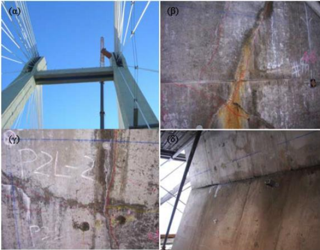
Σχήμα 8.6 (α) Έλεγχος σε πυλώνα της νέας γέφυρας του Ευρίπου, Χαλκίδα. Οι ελεγκτές βρίσκονται στο καλάθι που αναρτάται από γερανό ( http://geotest.gr/ ). Ενδείξεις σκουριάς (β) , αλάτων (γ) και υγρασίας (δ) σε κατασκευή από σκυρόδεμα ( http://www.tobi-tech.com/en/index.htm ).
