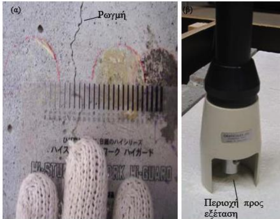
Σχήμα 8.10 Μέτρηση ανοίγματος επιφανειακής ρωγμής με απλό πλαστικό δείκτη (α) και μετρητή με μεγεθυντικό φακό ενσωματωμένη κλίμακα και φωτεινή πηγή (β).
