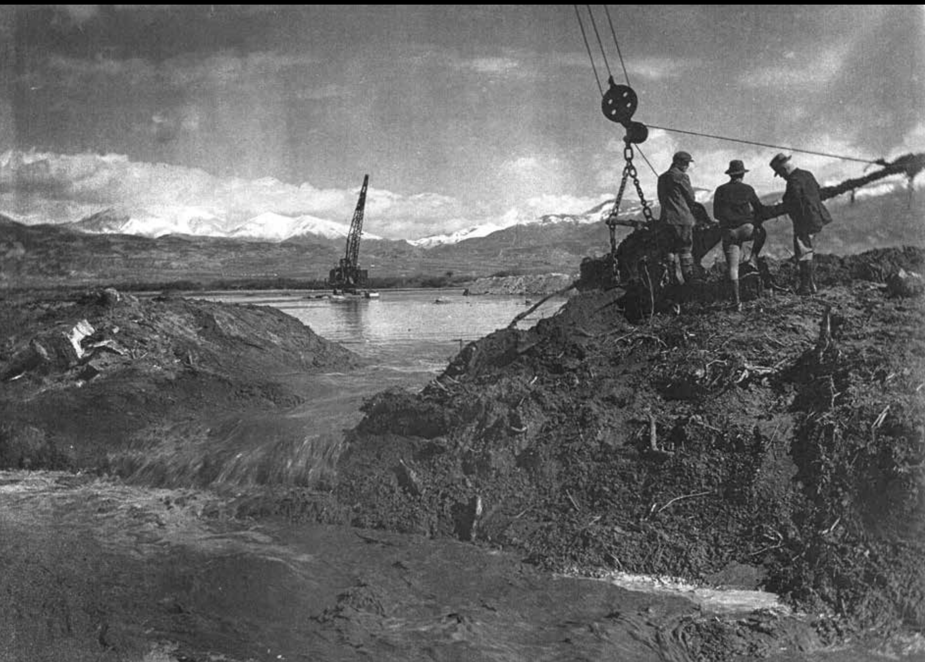
Ο αγροτικός εκσυγχρονισμός του μεσοπολέμου συνοδεύτηκε από μεγάλης κλίμακας αντιπλημμυρικά και εγχειοβελτιωτικά έργα. Η αμερικανική εταιρεία Foundation ανέλαβε το 1925 την κατασκευή παρόμοιων έργων στην πεδιάδα της Θεσσαλονίκης
