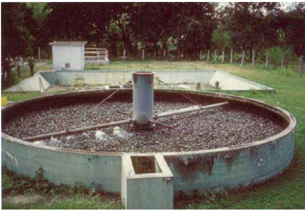
Εικόνα 6: Υπαίθρια δεξαμενή ενστάλαξης κατά τη δευτερογενή επεξεργασία των υγρών αποβλήτων.
